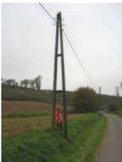
1473 : Poteau électrique en bois
