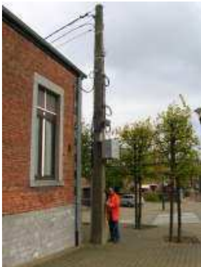
1471 : Poteau électrique en beton
