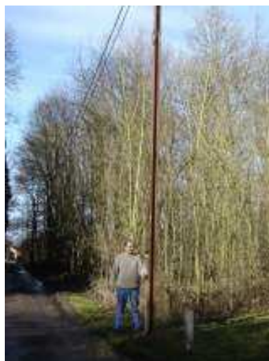
1474 : Poteau électrique métallique
