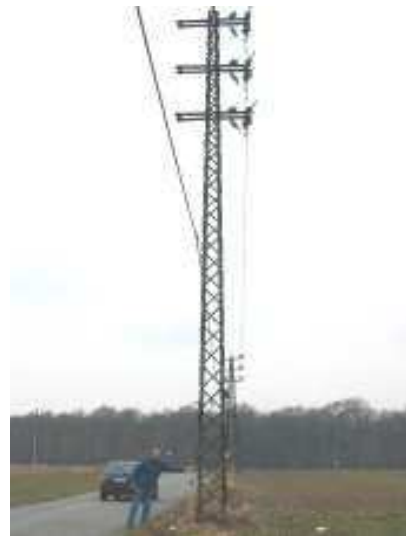
1472: Poteau électrique en treillis
